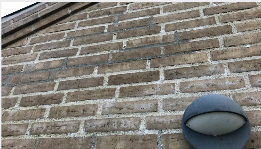
Figur 5.2 – 8 år gammelt hus, hvor manglende karbonatisering af mørtlen har været medvirkende årsag til misfarvninger og forvitring på murværksmaterialerne.
