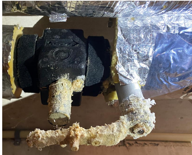
Indreguleringsventil på cirkulationsstreng defekt og utæt.
