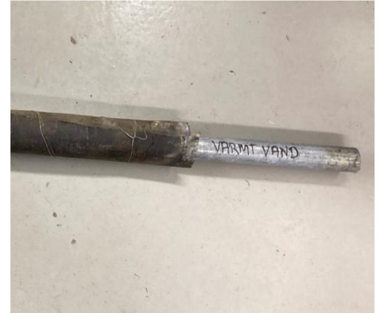
Galvaniseret stålrør med gammel isolering med mineraluld og pap.
