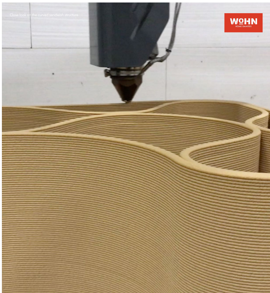
Træfiber-kompositmaterialet der er skræddersyet til 3D print skal på sigt fremstilles af affaldstræ og -plast
