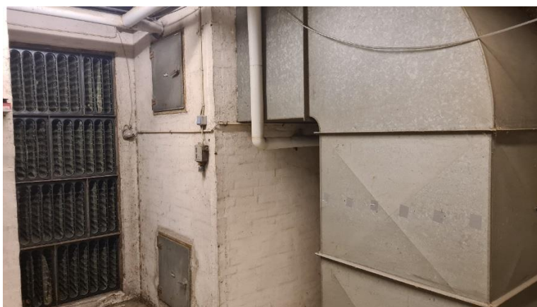
Figur 11.1.1.4 Målehuller i kanalen efter ventilatoren.
