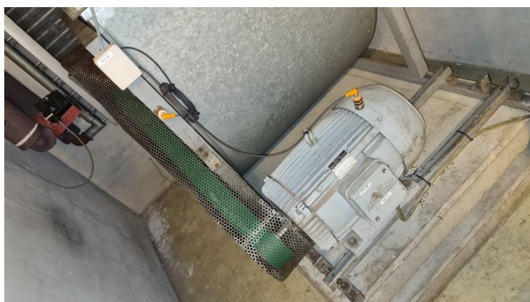
Figur 11.1.1.1 Ældre radialventilator og motor.
